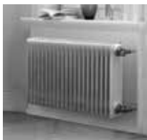
Vorher: Alter Heizkörper
