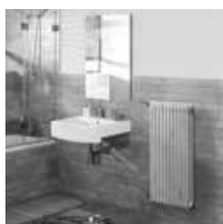
VORHER: Alter Heizkörper
