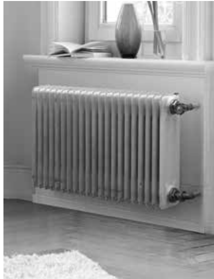
VORHER: Alter Heizkörper
